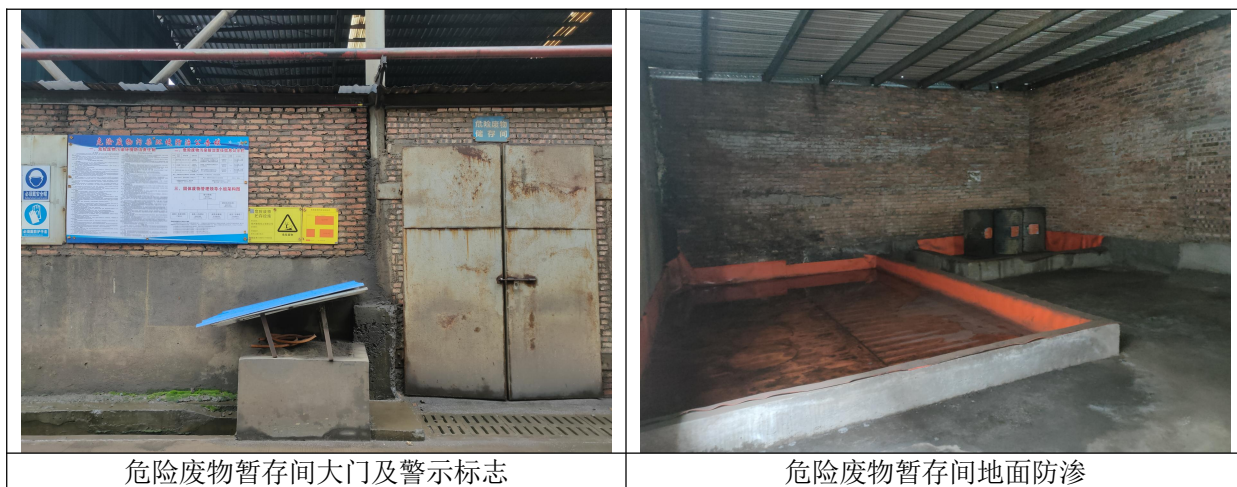
图 5.5-1 危险废物暂存间现场图
